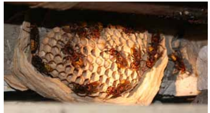
Hornissennest im Rollladenkasten (Foto: Hilligardt)
