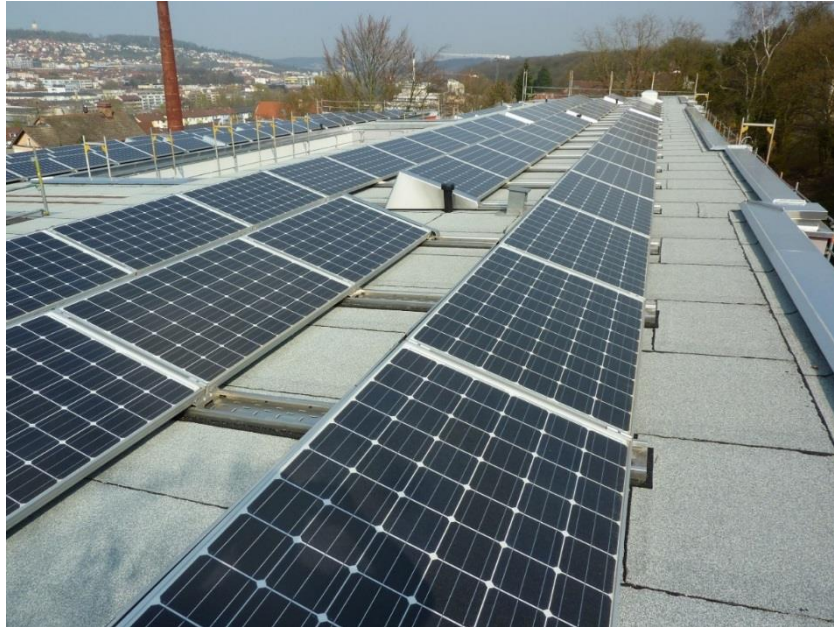
Abbildung 64 - Solarstromanlage auf dem Dach der Südstadtschule.
