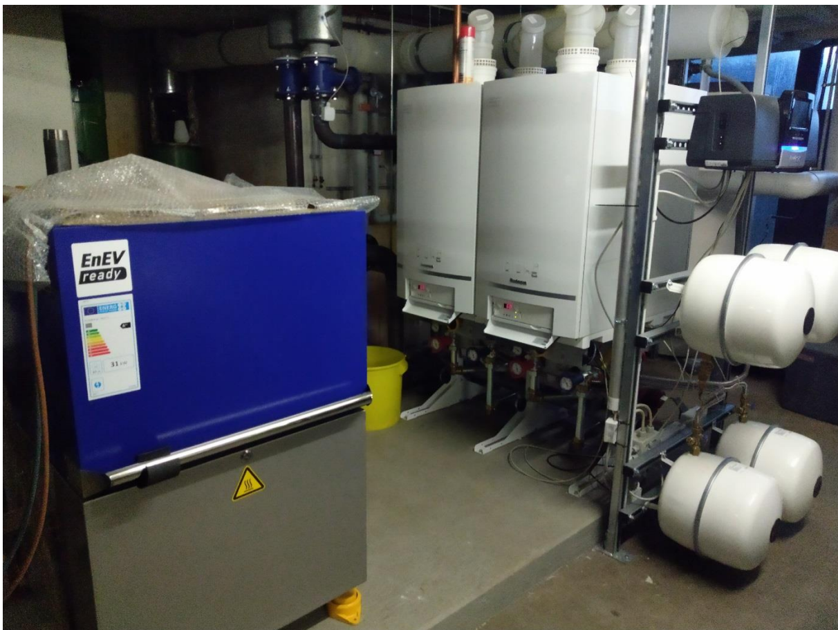
Abbildung 66 - BHKW sowie Flüssiggas-Brennwerttherme sind mittlerweile eingebaut und werden genutzt
