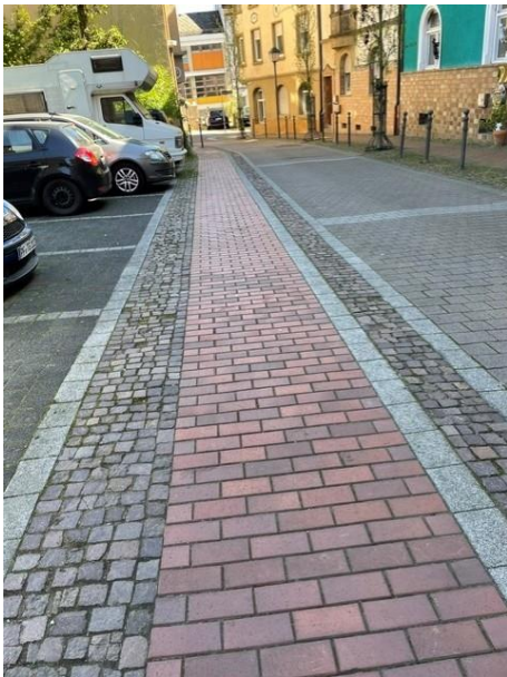
Amalienstraße, Ziegelsteine locker
