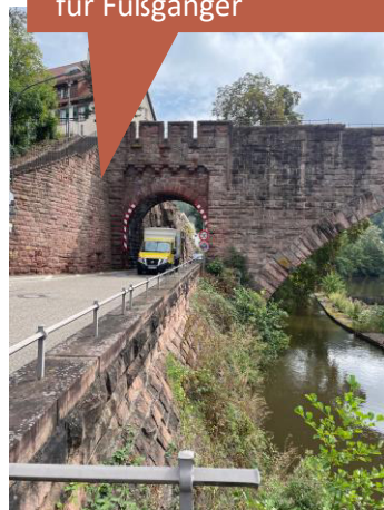
Schwierige Querung für Fußgänger
