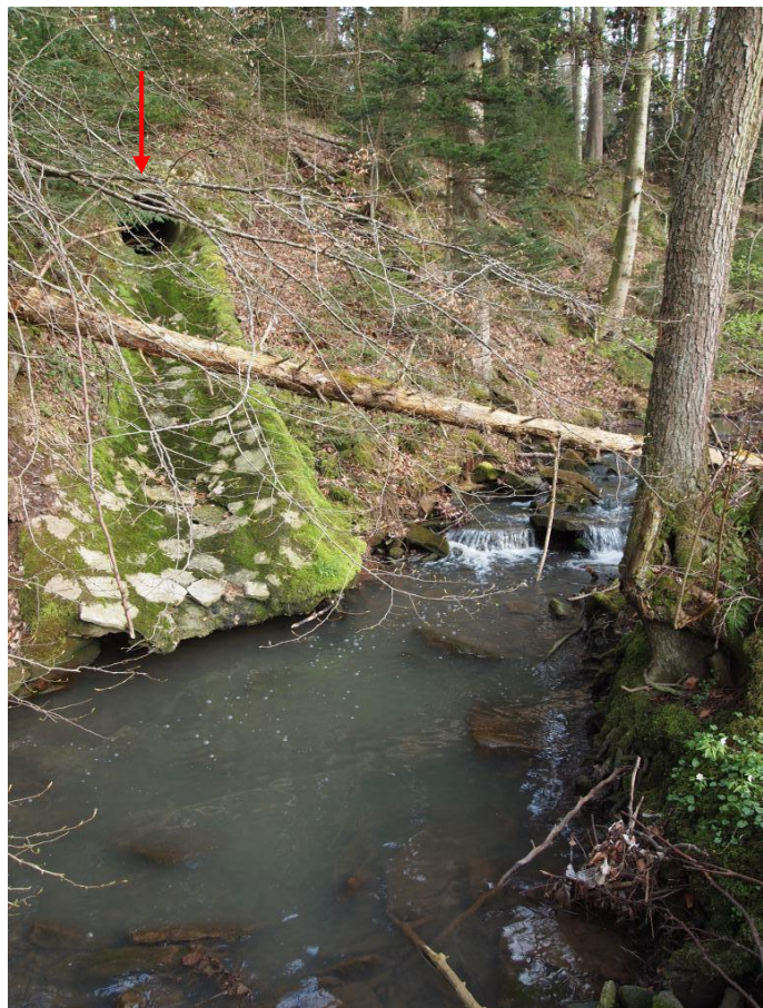
Abb. 32: An der Einleitungsstelle des RÜB „Birkhof“ (Pfeil) ist im Kirnbach ein großer Kolk entstanden. (Aufnahme am 8. April 2016).
